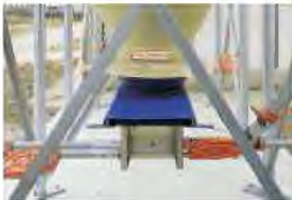
Рис. 3.9. Приемная воронка, смонтированная под бункером сухих концентрированных кормов
