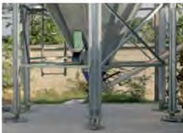
Рис. 9.5. Взвешивание бункера электронными тензодатчиками
