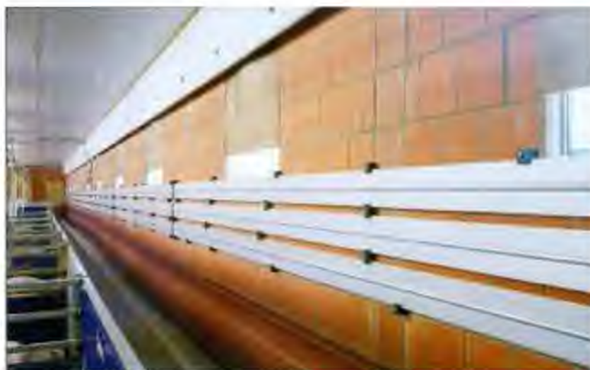
Рис. 6.20. Твин-трубы, смонтированные на стене
