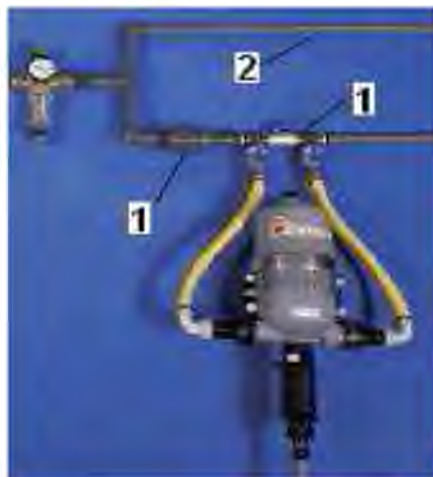
Рис. 4.6. Применение медикатора в кольцевом водопроводе:
