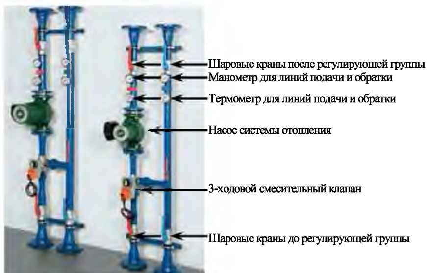
Рис. 11.21. Отопительный регулятор 300 кВт и 150 кВт
