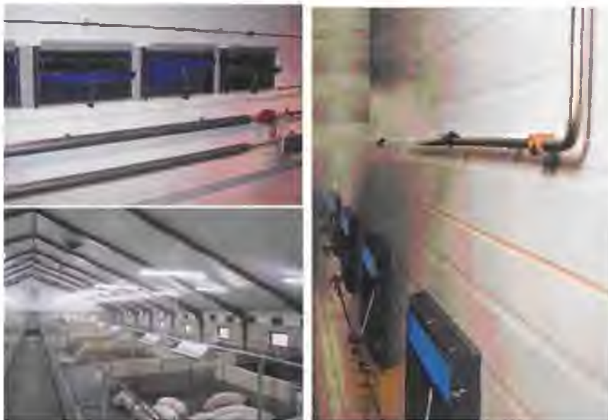
Рис. 6.5. Отопительные приборы свиарника для доращивания поросят
