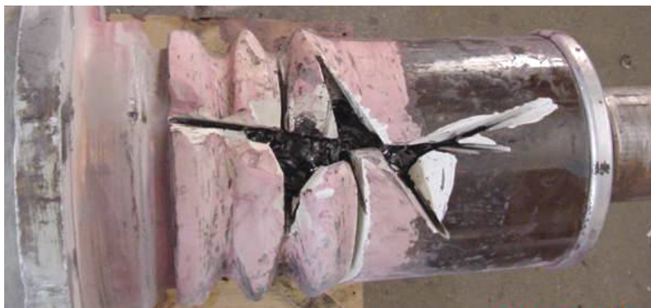
Рисунок 1.10 – Механическое разрушение длительно эксплуатируемого изолятора
