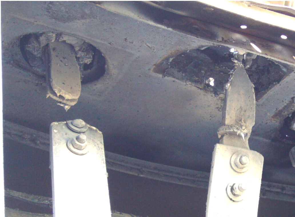
Рисунок 1.23 – Термические разрушения в результате КЗ на шинах
