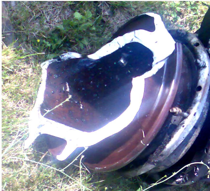
Рисунок 1.25 – Разрушение опорного изолятора в результате электродинамического воздействия
