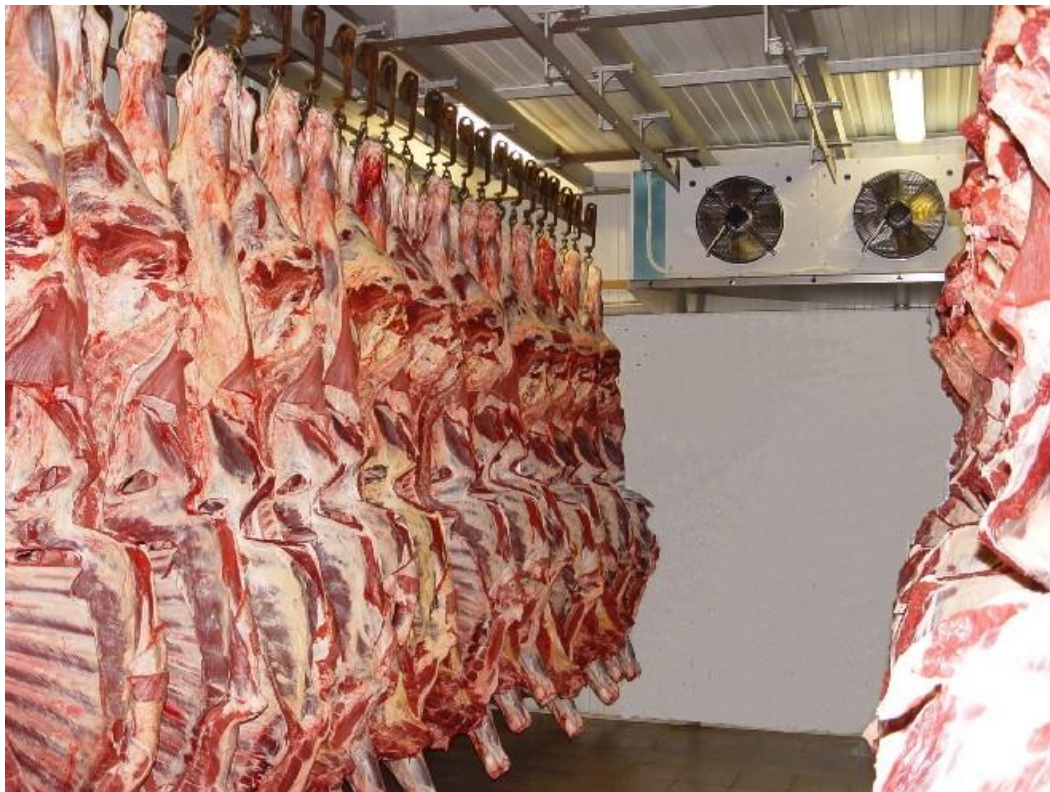
Рис. 44. Внутренний вид холодильной камеры охлаждения парного мяса
