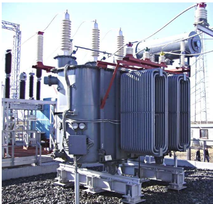
Рисунок 2.2 – Силовой трансформатор типа ТМН на ПС 110/10 кВ
