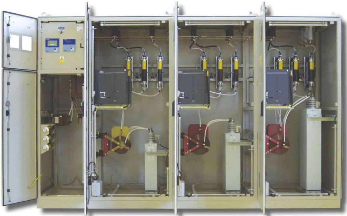
Рисунок Б1 – Установка для компенсации реактивной мощности
