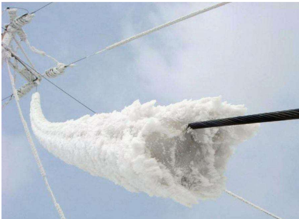
Рисунок 3.1 – Гололед на проводах ВЛ
