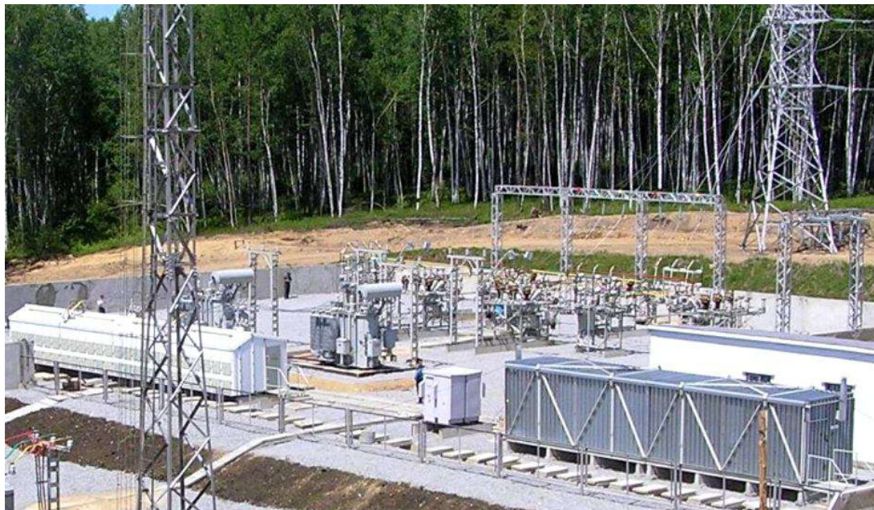
Рисунок 1.2 – Районная подстанция напряжением 35/10 кВ
