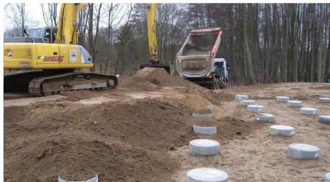
Рис. 5. Завершающий этап выполнения промежуточной подушки, являющейся основанием железной дороги в Германии (2012 г.)
