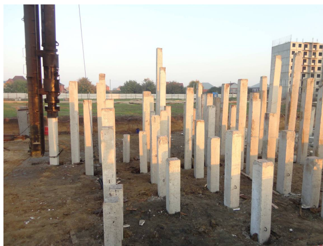
Рис. 3. Фактическое положение составных железобетонных свай заводского изготовления на участке строительства многоэтажных жилых зданий на правом берегу реки Кубани (Республика Адыгея) Fig. 3 Actual position of composite reinforced concrete driven piles at the construction site of multi-storey residential buildings located on the right bank of the river Kuban (Republic of Adygea)
