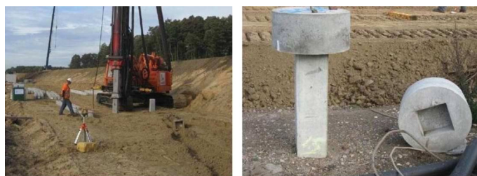
Рис. 4. Этап забивки свай и устройство сборных оголовков при строительстве железной дороги в Германии Fig. 4. The stage of pile driving and the installation of prefabricated caps during construction process of the railway in Germany
