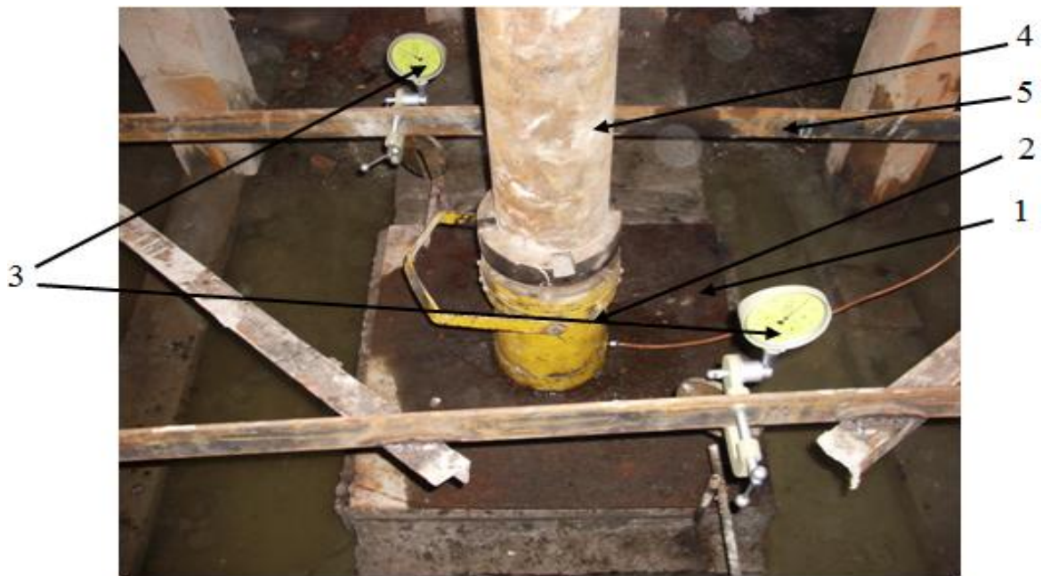
Рис.1.10. Фотография проведения штамповых испытаний в подвале здания. 1– штамп (ж/б фундамент) размерам 0,8м x 0,6м; 2 – домкрат; 3 – прогибомеры; 4 – металлическая труба-стойка диаметром 150 мм; 5 – реперная система.
