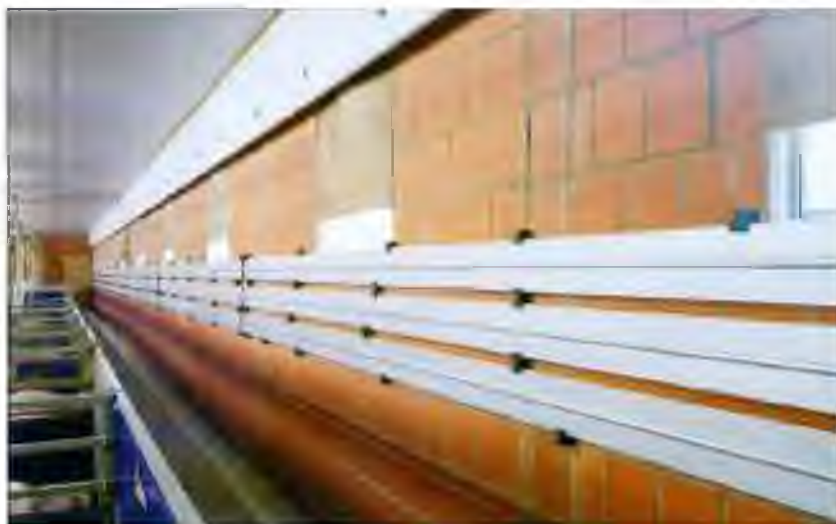
Рис. 6.20. Твин-трубы, смонтированные на стене
