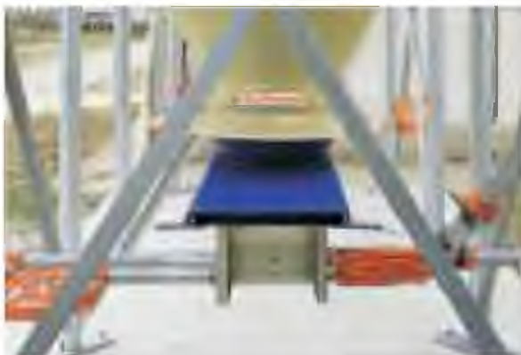
Рис. 3.9. Приемная воронка, смонтированная под бункером сухих концентратов
