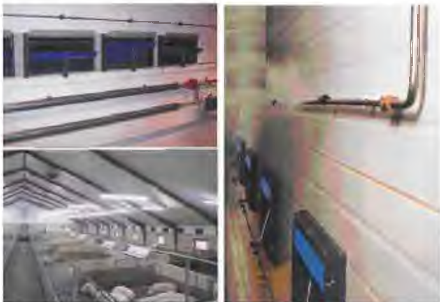
Рис. 6.5. Отопительные приборы свиарника для доращивания поросят
