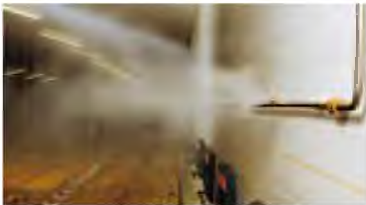
Рис. 11.37. Система охлаждения, увлажнение, замачивание «Fogging Cooler»
