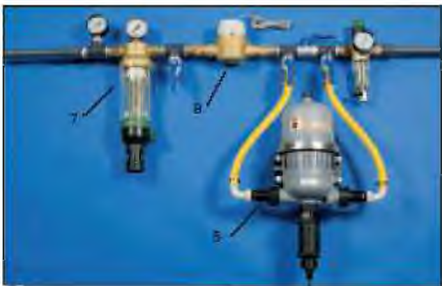
Рис. 10.12. Узел водоподготовки воды с медикатором
