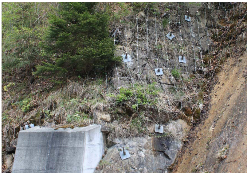
Рисунок 1.2 – Анкерное крепление неустойчивого блока с применением высокопрочной сетки: а – схема сооружения; б – общий вид
