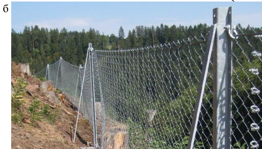
Рисунок 1.4 – Защитное сетчатое ограждение с вертикальными стойками: а – схема сооружения; б – общий вид
