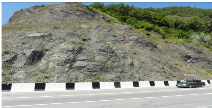
Рисунок 48 – Подпорная стенка «габионы» и защитная сетка от осыпания и обвалов камней в районе поселка Красная поляна
